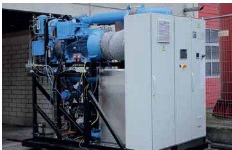
90kw—ORC発電ユニット
